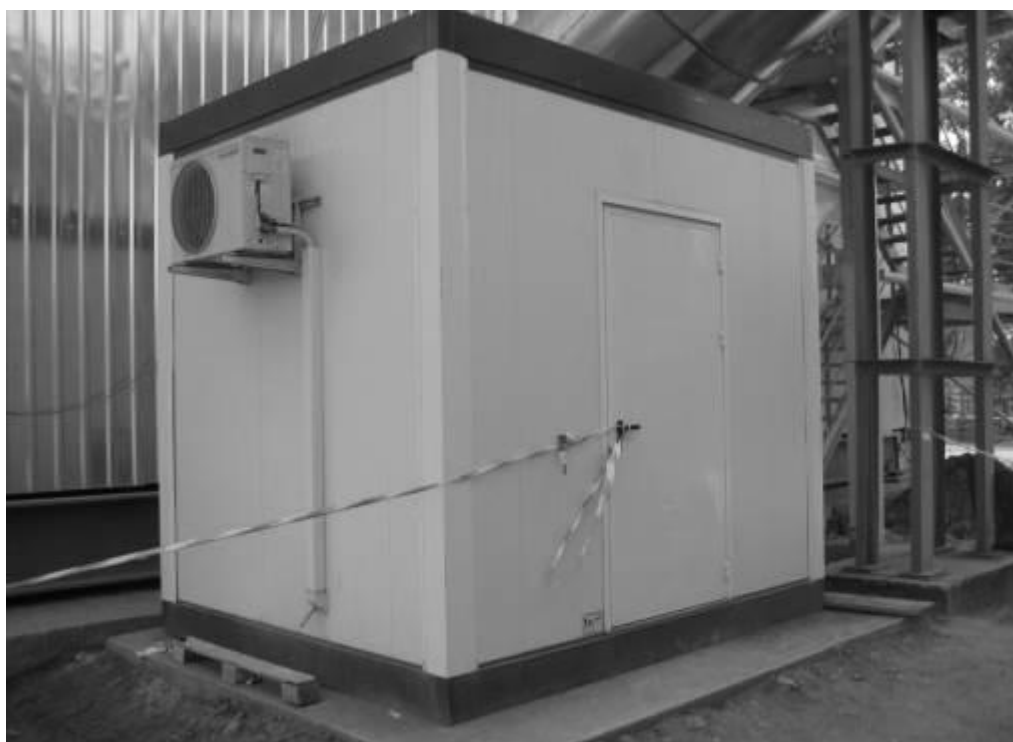
Рис. 4.5 АПС на базі всепогодного блок-контейнера
